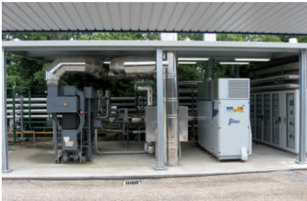
Figura 3 - Impianto di trigenerazione
