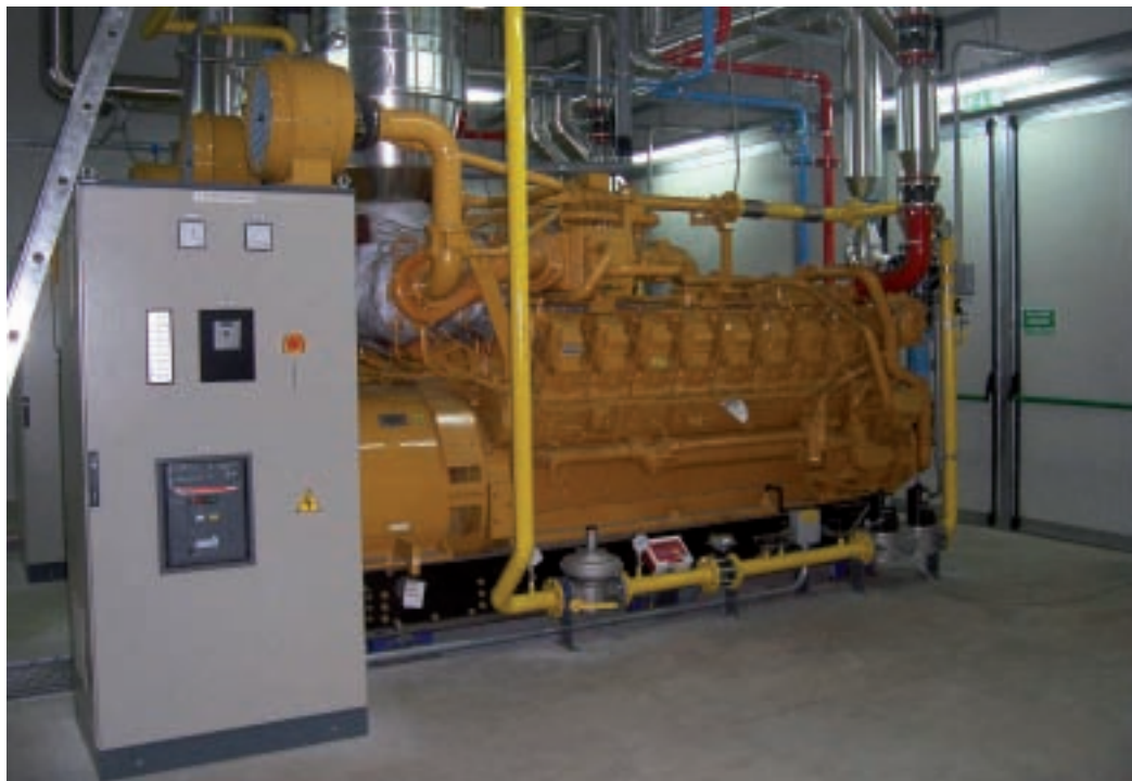
Figura 10 - Motore a combustione interna in una centrale di cogenerazione.
