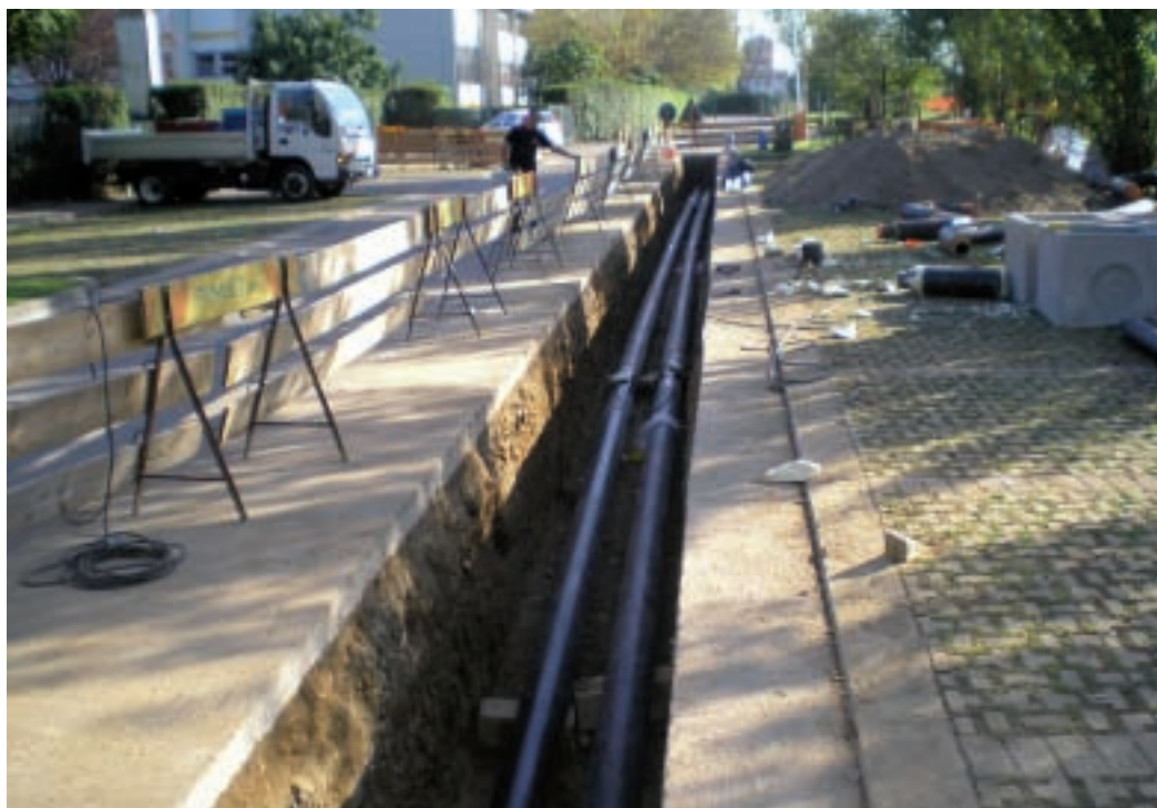
Figura 9 - Posa delle tubazioni della Rete di Teleriscaldamento a servizio di una centrale di cogenerazione.
