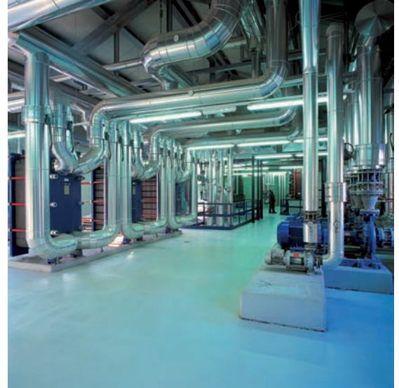
3 - Interno impianto a co-generazione Bioenergia Fiemme
