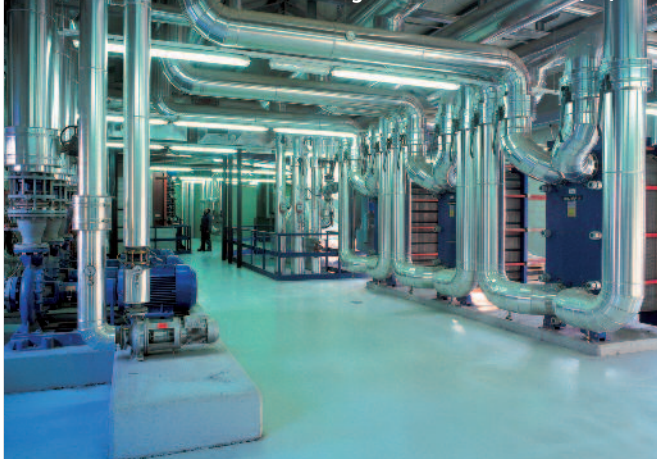
Interno Cavalese: Centrale Bioenergia Fiemme a Cavalese (TN)
