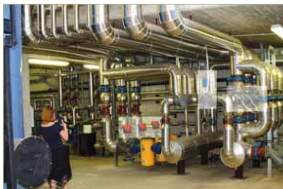
Società Energetica Aostana Centrale di Morgex (AO): tubazioni della rete di teleriscaldamento
