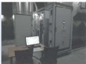
FIGURA 1 Impianto pilota RSE per l'abbattimento combinato particolato di combustione/NO x in esercizio presso la centrale termica di TCVVV a Tirano (SO)
