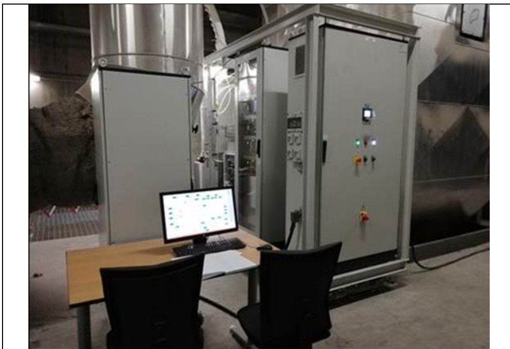
Figura 2 – Impianto pilota RSE per l'abbattimento combinato particolato di combustione/NOx in esercizio presso la centrale termica di TCVVV in Tirano (SO)
