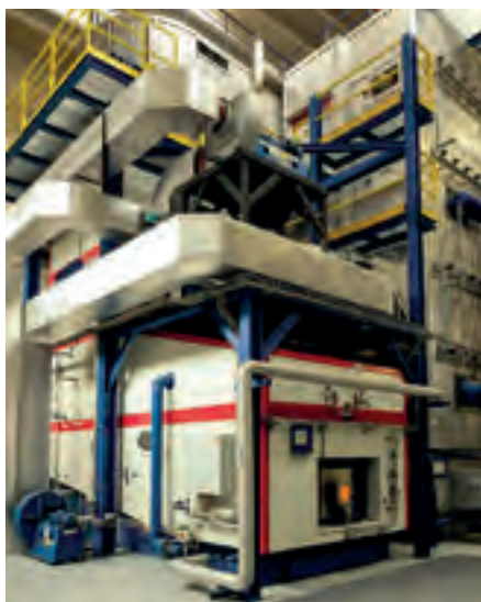
Figura 4. Caldaia a biomassa in una centrale termica di un impianto di teleriscaldamento (fonte: Giovanni Riva)
